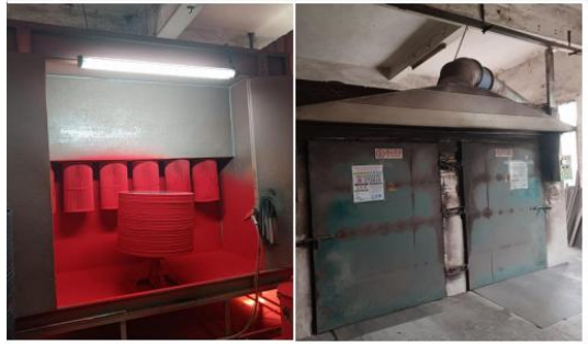
喷粉和烤箱防护设施
