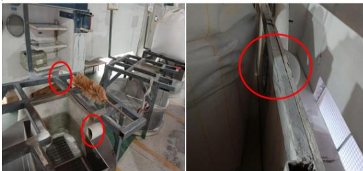
备料车间集尘管道
