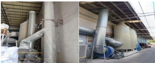
备料车间和筛料房除尘器
