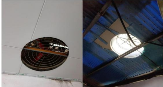
一号配浆房、固化剂仓排风机
