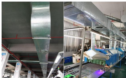
空調送風系統和抽風管道
