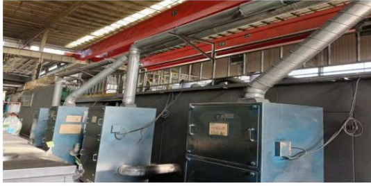
混料区除尘器
