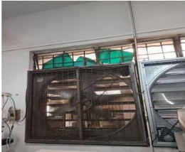
激光焊接车间轴流风机
