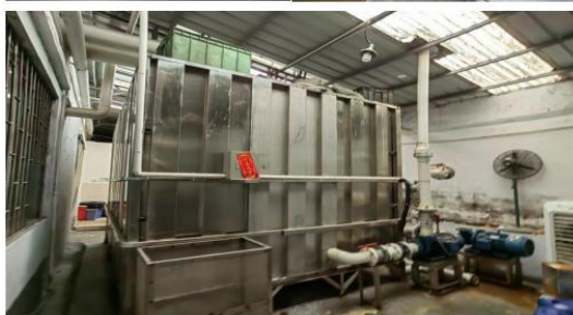
水帘柜和废气净化处理设施
