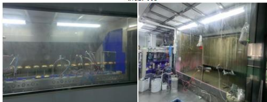
自动化喷漆和半自动化喷漆水帘柜
