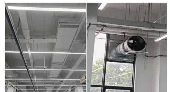
中央空调和排风机
